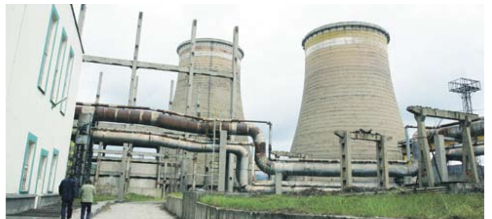
▶ „Топлофикация Перник“ е закупила вече част от оборудването за изграждане на сероочистна инсталация съгласно комплексното разрешително
