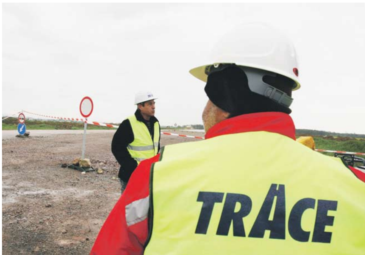
▶Строежът на автомагистрала “Тракия” в отсечката Стара Загора - Нова Загора е един от най-големите проекти, изпълнявани от “Трейс груп холд”
