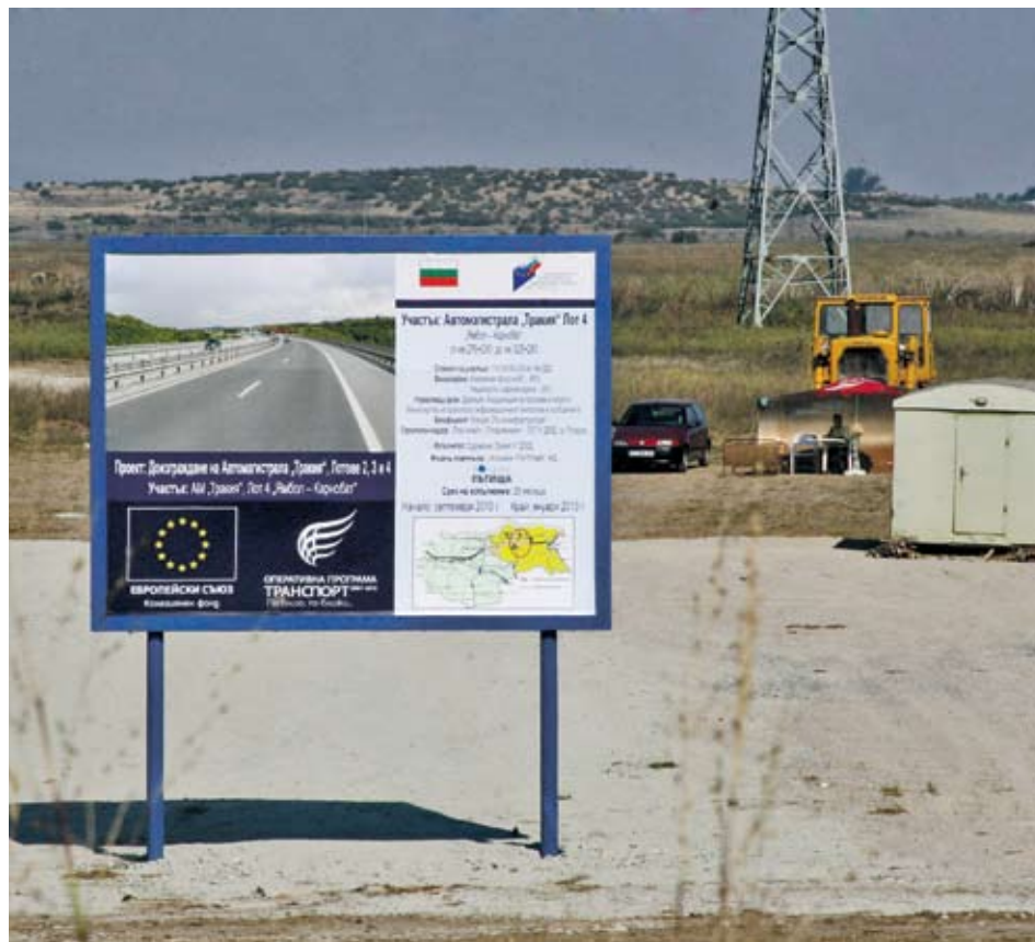
► Изоставането със строежа на магистрала "Тракия" е наваксано, това показва проверката на премиера Бойко Борисов СНИМКА БОБИТОШЕВ
